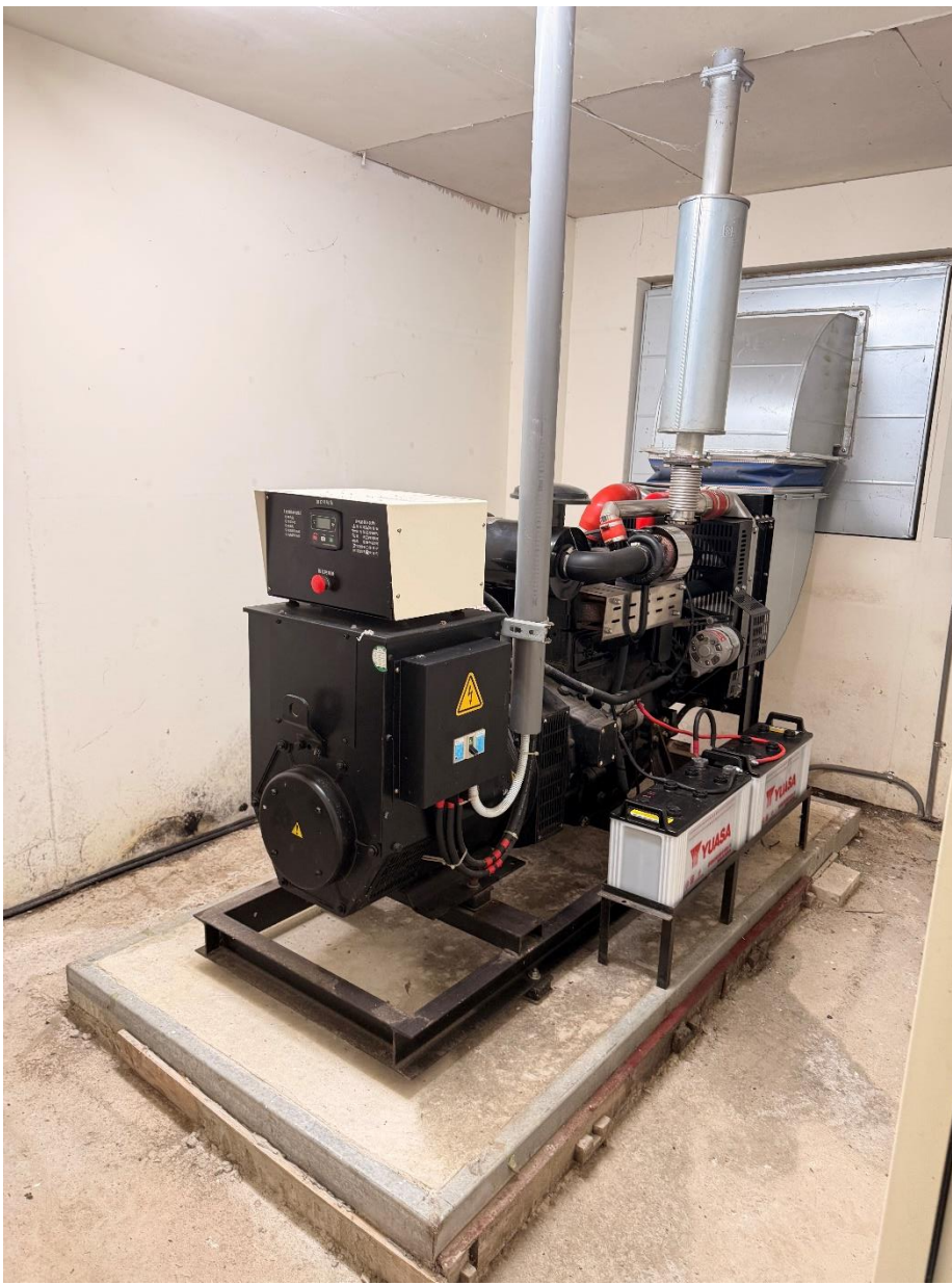
(消防灑水設備發電機組)
